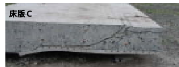
写真 - 1 橋軸直角方向のひび割れ状況写真
