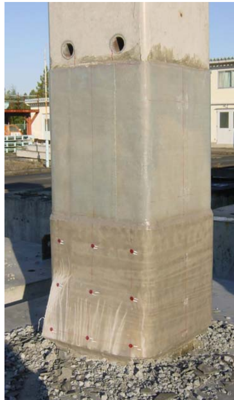
写真-1 試験終了後の VFRP 破断状況
