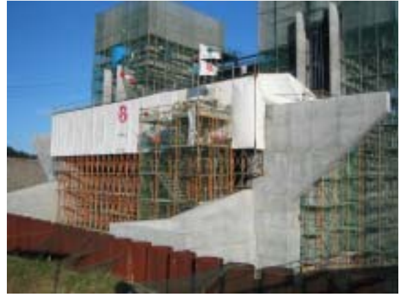
写真-1 養生設備外観
