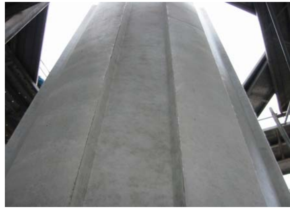
写真－8 建築工事（打放しコンクリート）への適用例（中込委員提供）
