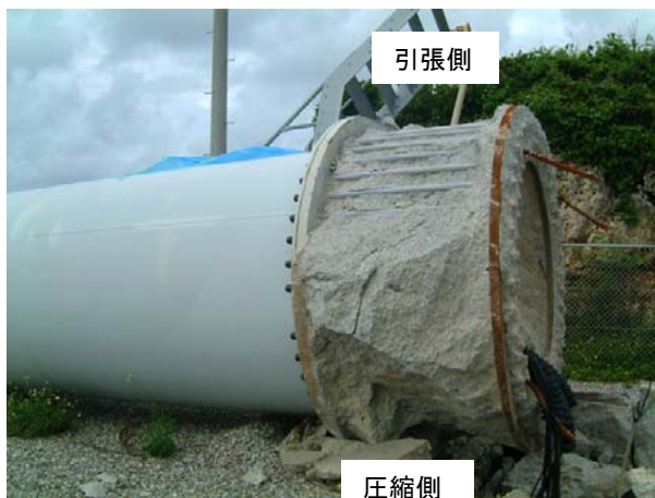
(a)風車倒壊(側面)
