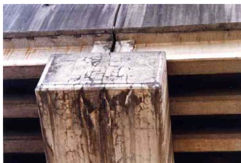
写真-2 橋脚はり部劣化状況
