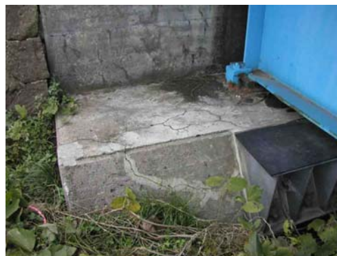
写真-1 橋台端部劣化状況
