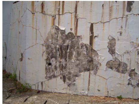
写真-3 補修部の再劣化状況
