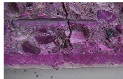
写真-1 「ひび割れ部」DFRCC 複合体 (荷重 17.0kN, ひび割れ幅 0.04mm) ※中央部に見られるひび割れは割裂時のもの
