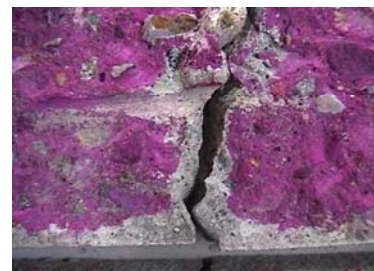
写真-2 「ひび割れ部」ORC 複合体 (荷重 17.0kN, ひび割れ幅 4.00mm)
