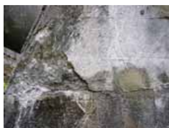
写真 - 5 B 構造物のはく落状況
