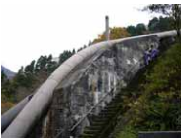
写真 - 1 A 構造物の劣化状況
