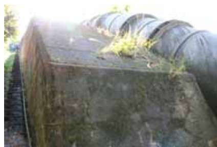
写真 - 2 B 構造物の劣化状況
