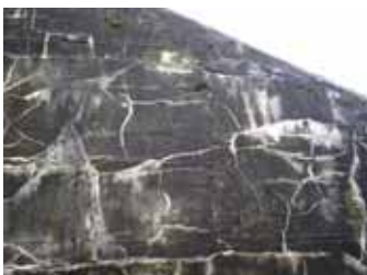
写真 - 4 B 構造物の劣化状況
