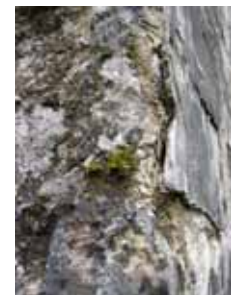
写真 - 3 A 構造物のはく落状況
