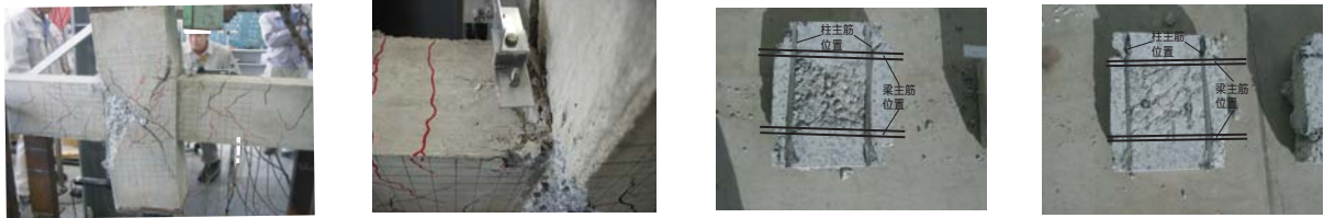
(g) 全体の破壊状態(東面) (h) 梁端部コンクリートの圧縮破壊状態 (a) 試験体 No.1 (b) 試験体 No.2
