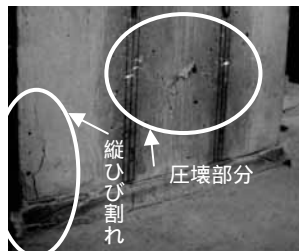
写真 - 1 第1ブロック 圧壊状況 ( R = 1.3\% )
