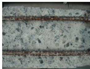
(b)鉄筋腐食状況
