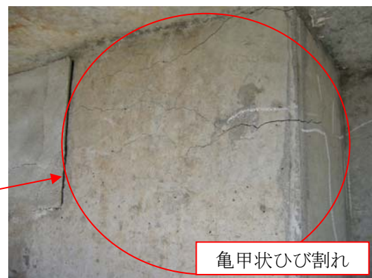
写真-3 ダイヤフラムのひび割れ状況
