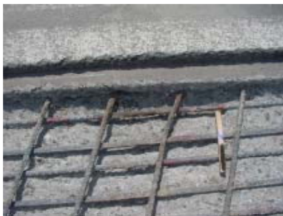
写真-6 局所的な鉄筋腐食
