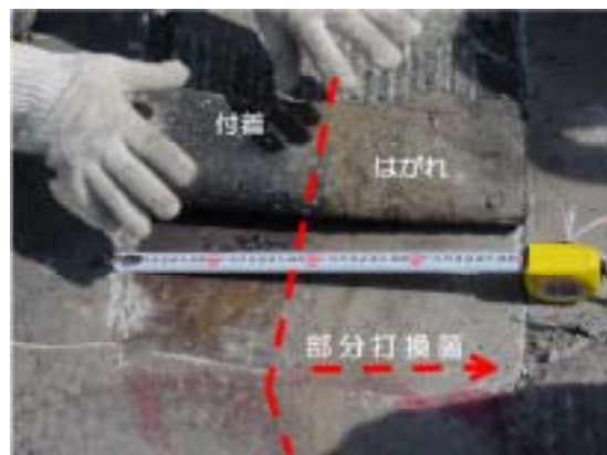
写真-4 防水シートのはがれ状況
