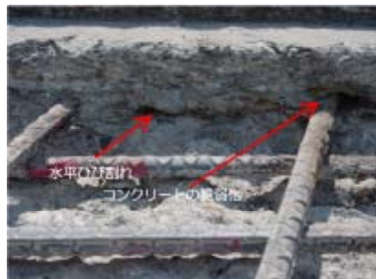
写真-5 増厚と既設床版の界面はく離
