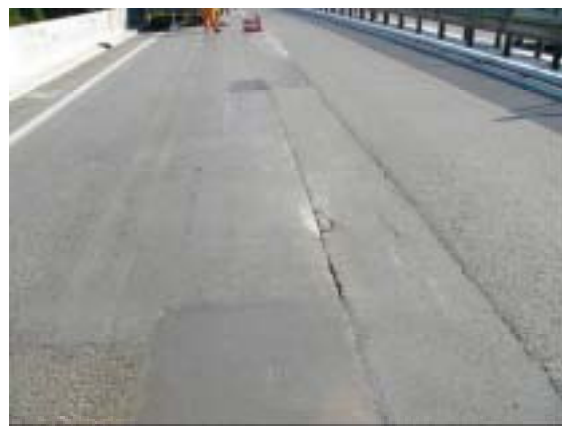
写真-1 B橋（上り線）の路面状況
