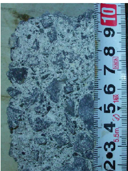
写真-1 表面のスケーリング (85A)
