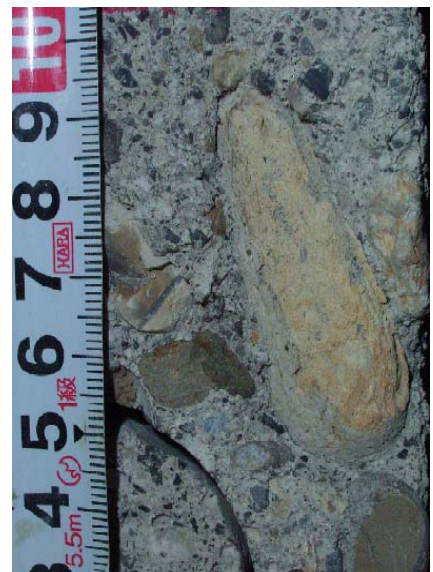
写真-3 骨材の劣化 (55A-G2 左下の円弧は削孔あと)
