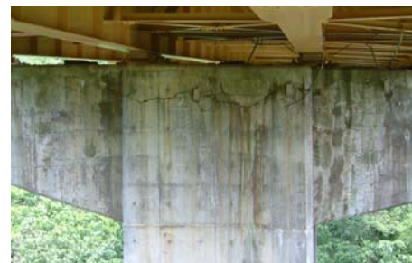
写真 - 9 鹿島橋枕梁部のひび割れ状況
