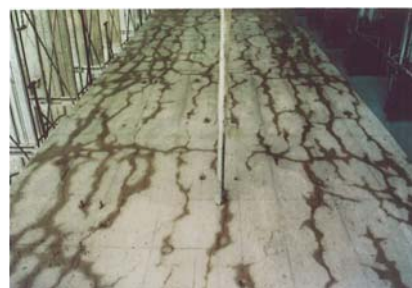
写真 - 3 豊川橋柱部のひび割れ状況
