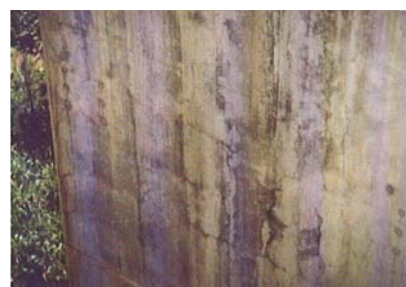
写真 - 5 安津見高架橋柱部のひび割れ状況
