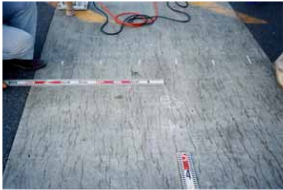
写真 - 9 PC 舗装の劣化状況
