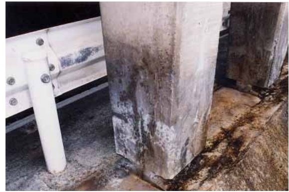
写真-7 コンクリート製品(PCa)の劣化状況
