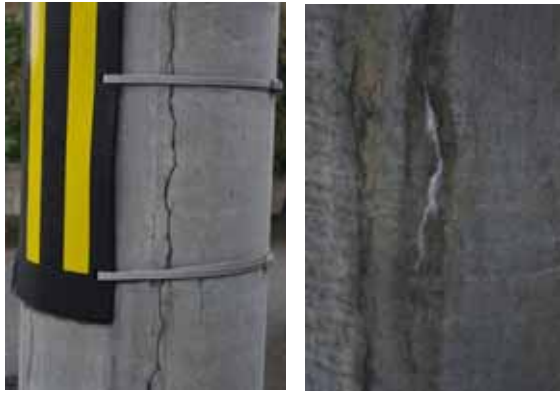
(a) 縦方向のひび割れ (b) ASRゲルの滲出 写真-6 コンクリート製品(PCa)の劣化状況
