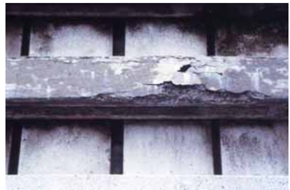
写真 - 5 コンクリート製品 (PCa) の劣化状況
