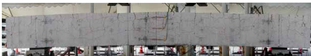
写真 - 1 PC 梁部材の劣化状況 (材齢 15 ヶ月)
