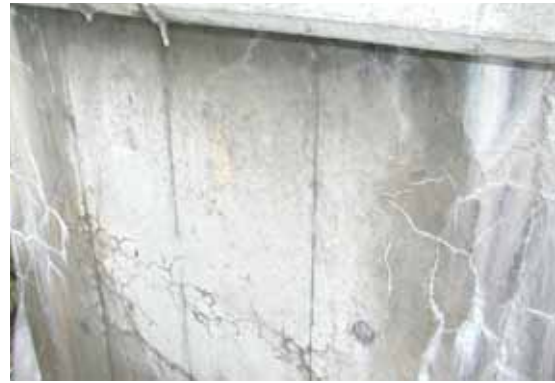
写真 - 14 PC水槽の劣化状況（側面）
