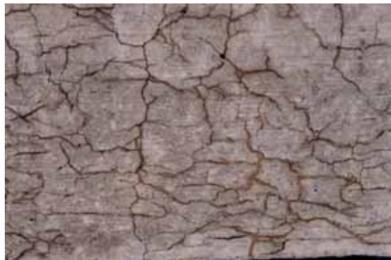
写真 - 11 亀甲状のひび割れ (端部)
