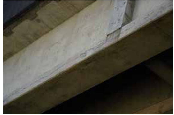
写真 - 3 ポステン PC 桁の劣化状況
