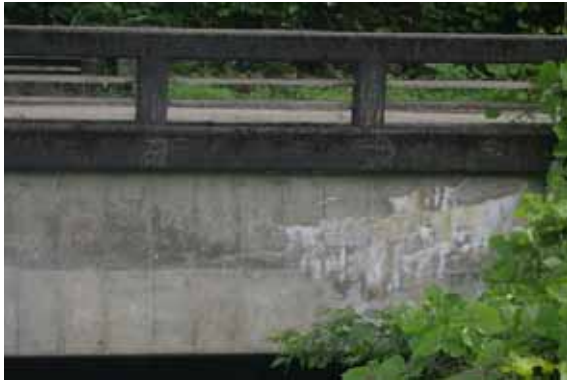
写真 - 2 PC 箱桁の劣化状況
