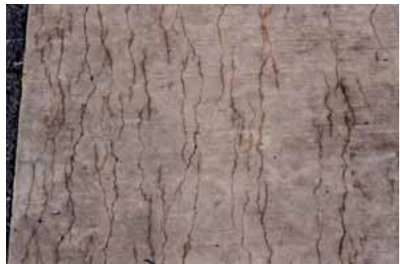
写真 - 10 PC 鋼材に沿ったひび割れ (中央部)
