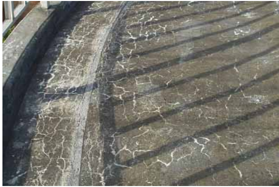
写真 - 13 PC水槽の劣化状況（上面）
