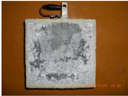
40℃乾湿繰り返し：小型試験体「Z」 (白い変色部分が溶射膜の浮き)
