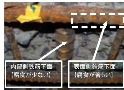
写真 - 1 実際の床版下面の鉄筋腐食状況
