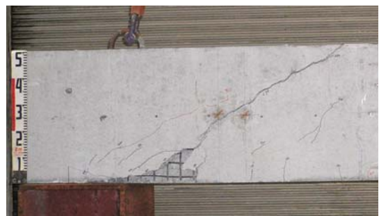
図-8 支点付近の剥離状況
