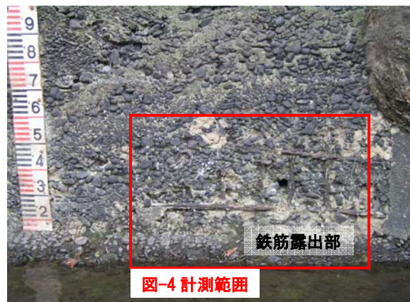
写真 - 1 損傷の進行したコンクリート水路壁面 (昭和9年施工, 損傷部)
