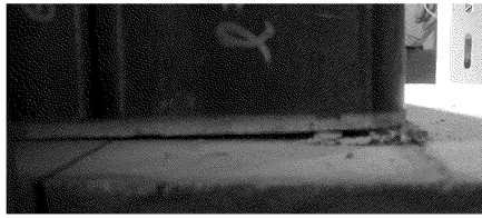
写真-1 基礎梁と柱との境界の隙間 (2-0.15-t6)
