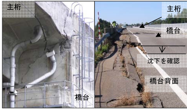
a) 衝突の痕跡 b) 橋台背面の損傷
