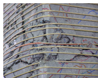
写真-3 詳細ひびわれ状況(ケース 3)
