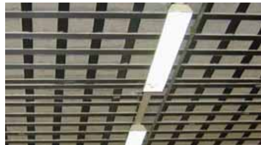
写真 - 1 CFRP 成型板による RC 造倉庫スラブ（下面）補強事例
