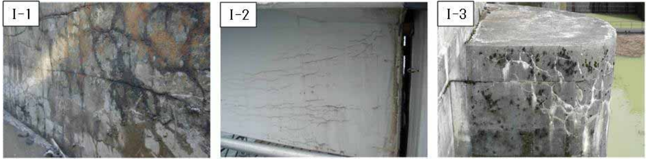
写真-2 石川県における代表的な ASR 劣化構造物の外観
