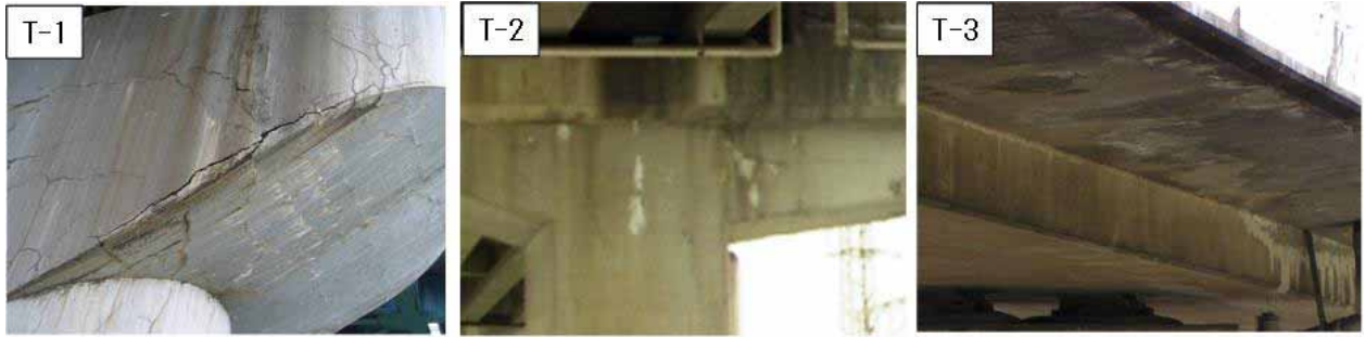
写真-4 富山県における代表的な ASR 劣化構造物の外観
