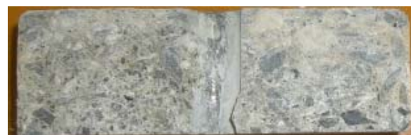
写真-5 ひび割れ幅0.263mmの中性化状況
