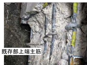
図-17 既存部上端主筋の変形
