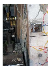
図-9 コンクリートの剥離
