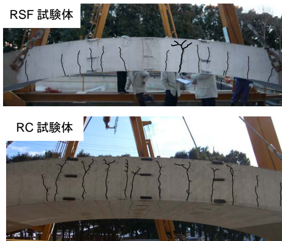
図-6 ひび割れ性状（荷重終了時）
