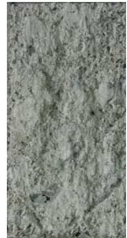
写真-2 破壊状況
