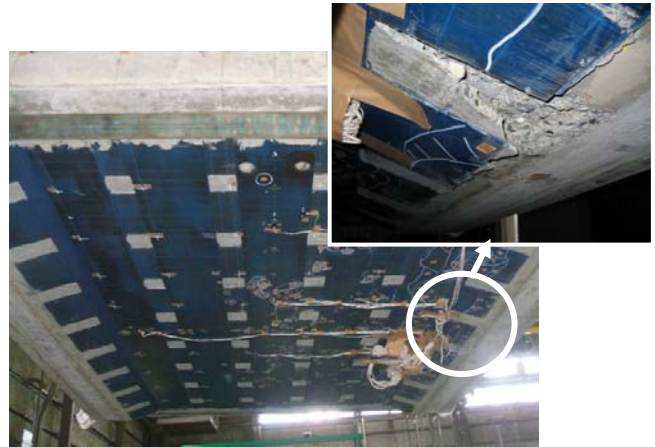
写真-2 No.3 実験終了時の下面の状況
