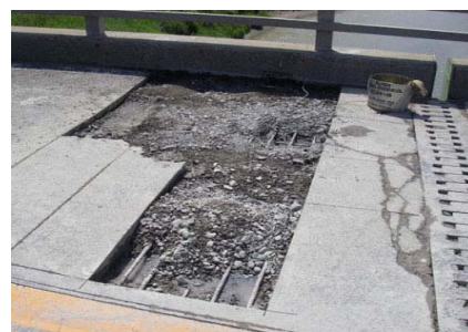
写真-1 凍害損傷（砂利化状況）
