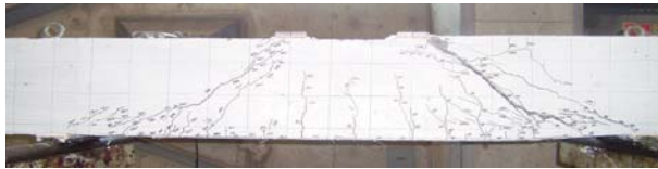
写真-6 破壊状況 (AS-S1)
