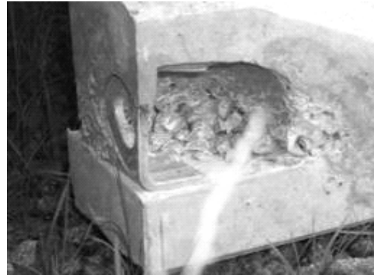
写真-1 不具合事例の例 (連結金具部の充填不足)
