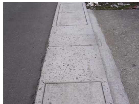
写真-2 不具合事例の例 (凍結防止剤散布によるポップアウト)
