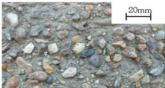
写真-3 洗い出し後に露出した粗骨材
