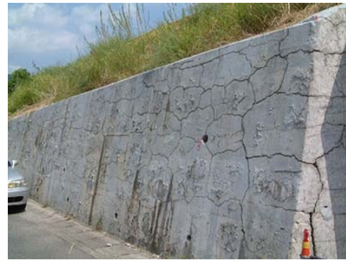
図-1 構造物の劣化状況
