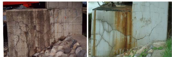
第 1 次補修前 第 2 次補修前 写真-1 ASR による表面被覆の再劣化
