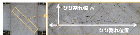
図-13 ひび割れ形状の確認
