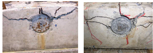
写真-3 定着具周辺の破壊の様子（左：T0, 右：T15）
