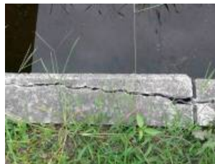
写真 - 3 止水板端部から伸びるひび割れ
