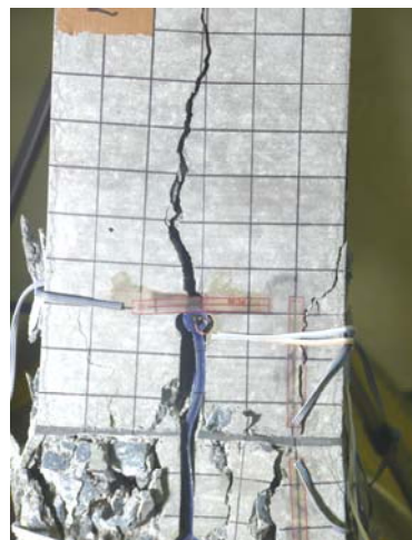
写真 - 9 供試体 2 の試験後の破損状況
