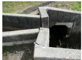
写真 - 4 水路の突出による分水柵の破損
