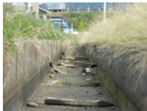
写真 - 2 コンクリートの連続した剥落
