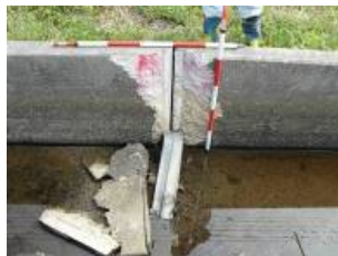
写真 - 1 目地部のコンクリートの剥落
