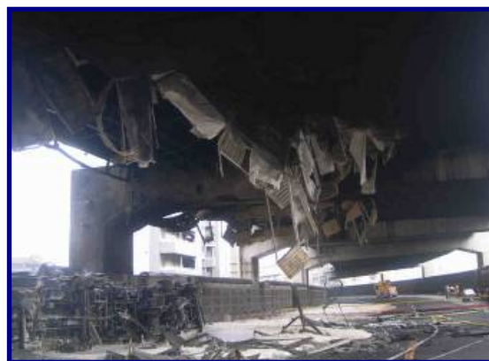
写真-1 被災状況全景 (鎮火直後) 7)
