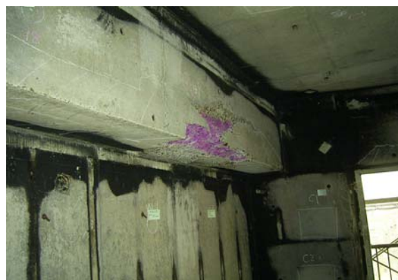
写真-2 梁隅角部に生じた浮き
