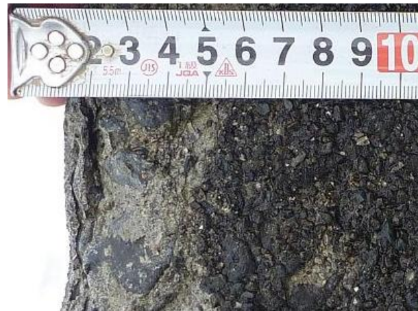
写真-2 天端における層状ひび割れ
