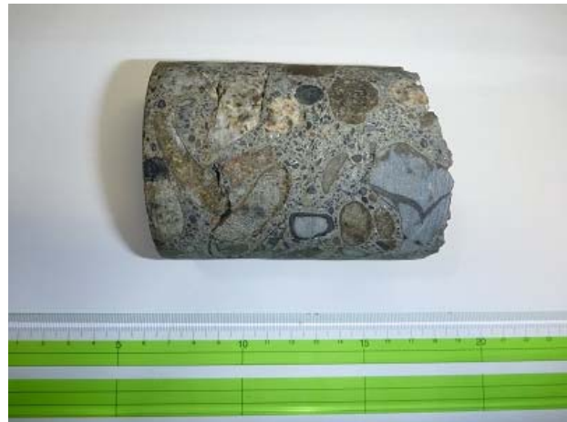
写真-3 側壁部材厚方向への層状ひび割れ
