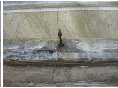
(c) 横締め PC 鋼棒の抜け出し (プレテンスラブ桁)
