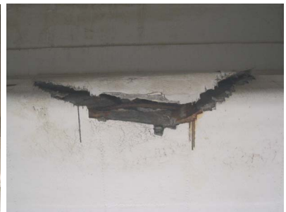
(i) 炭素繊維シートの破断事例 (ポステン T 桁)
