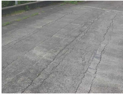
(b) 舗装面のひび割れ (プレテンスラブ桁)
