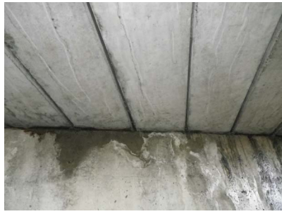
(a) 主桁のひび割れ (プレテンスラブ桁)
