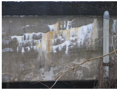
(e) 主桁のひび割れ (ポステン中空床版)
