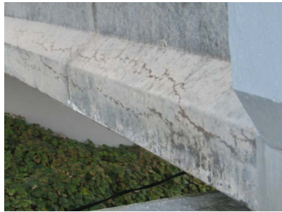
(d) 主桁のひび割れ (プレテン T 桁)
