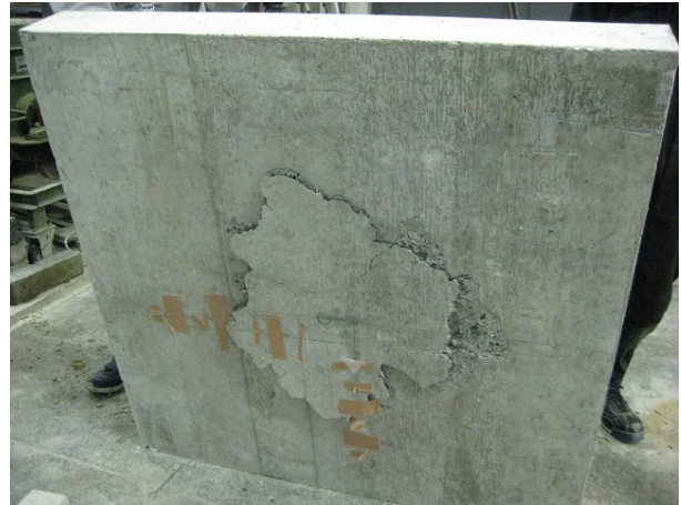
写真-5 劣化床版の試験後（下面の状況）
