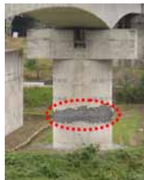
写真-1 地震後の RC 橋脚損傷事例
