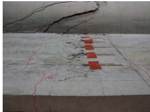
写真-3 BW4-1破壊状況（壁上側）
