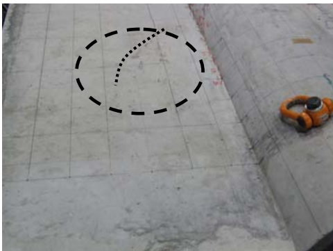
写真-2 BW3-1破壊状況（壁上側）
