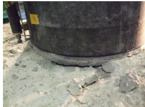
写真-1 損傷状況 (A橋、フーチングとの境界面)
