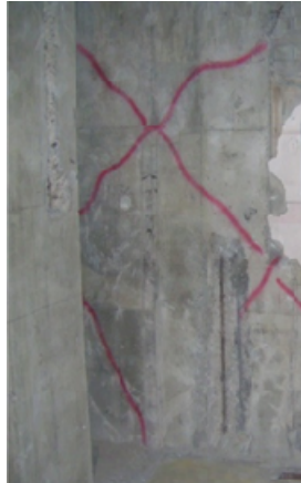
写真 - 1 2階1通り B-C間の境界梁
