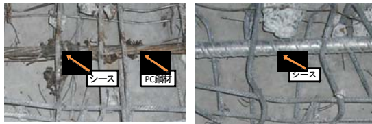
(a) W1-1-10 (b) W0-1-10 図-5 解体後のコンクリート内部状況の例
