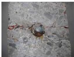
図-6 コンクリート断面状況の例
