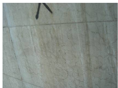
(c) 亀甲状のひび割れ
