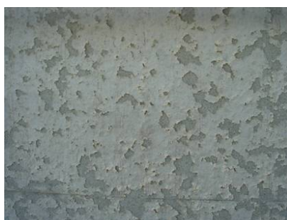
(b) 表面剥離
