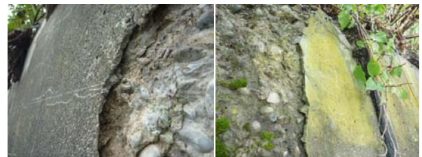
写真一 側壁表面部の層状ひび割れ
