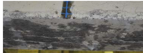
写真-2 下面の軸方向ひび割れ (T10)
